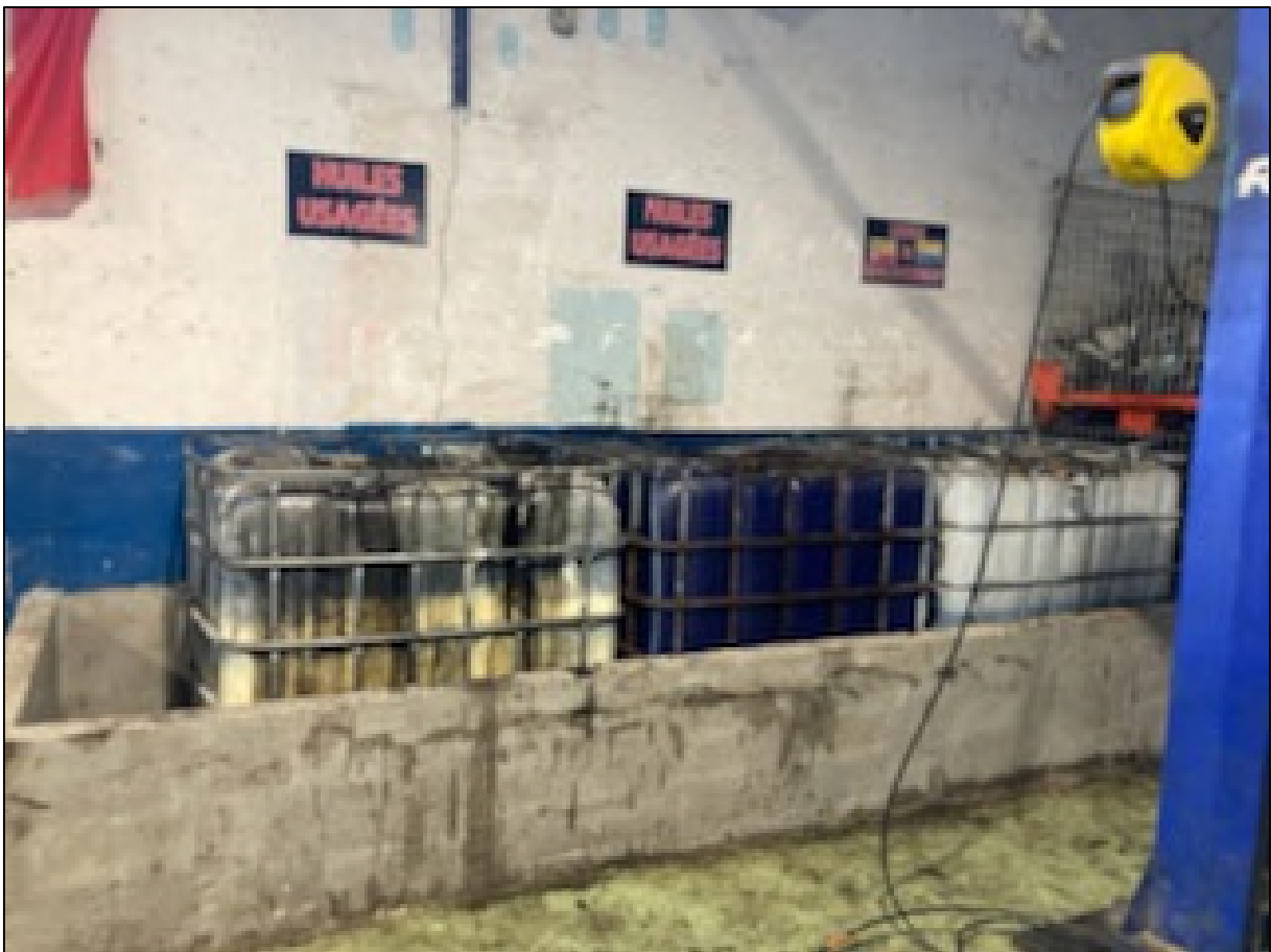
Cuve de stockage des fluides issus de la dépollution (sur rétention maçonnée)
